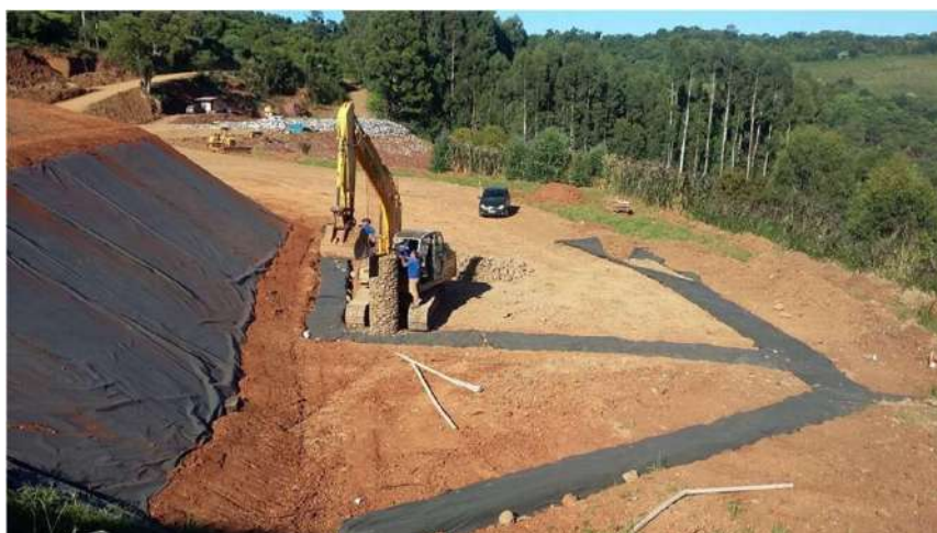
Figura 33: Sistema de drenagem de chorume e gás. Fonte: Aterro Sanitário CRI Ltda em Ipumirim SC
