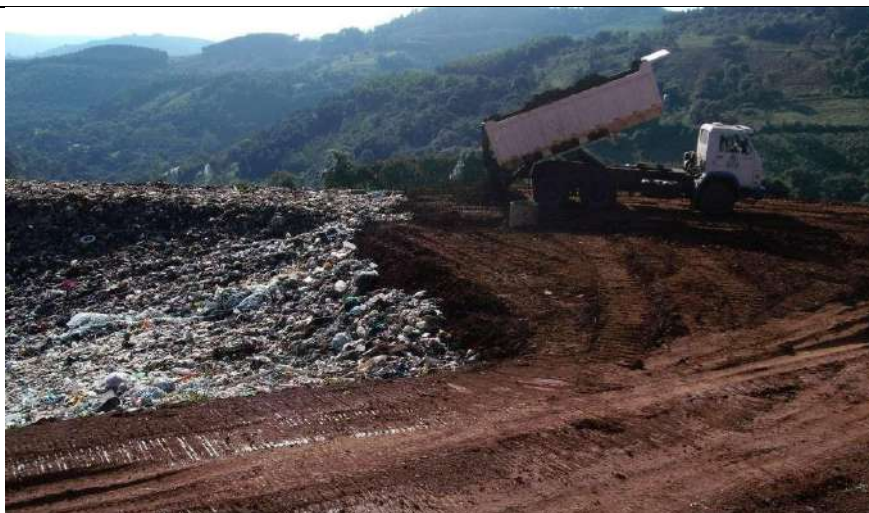
Figura 32: Cobertura dos Resíduos. Fonte: Aterro Sanitário CRI Ltda em Ipumirim SC
